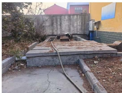
生活区一体化污水处理设施
