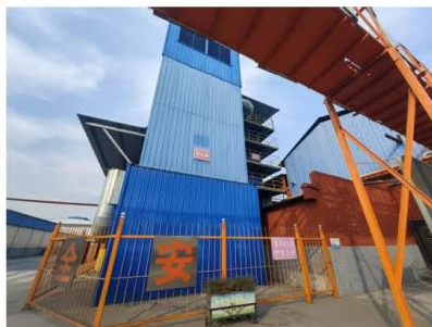
除尘脱硝设施
