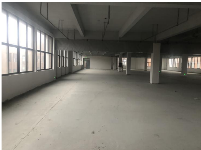
生产车间（位于二层）
