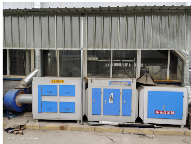
项目改建前有机废气治理设施
