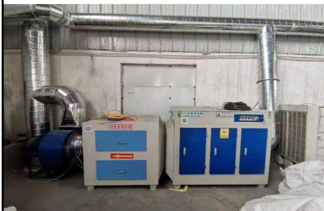
现有工程环保设施
