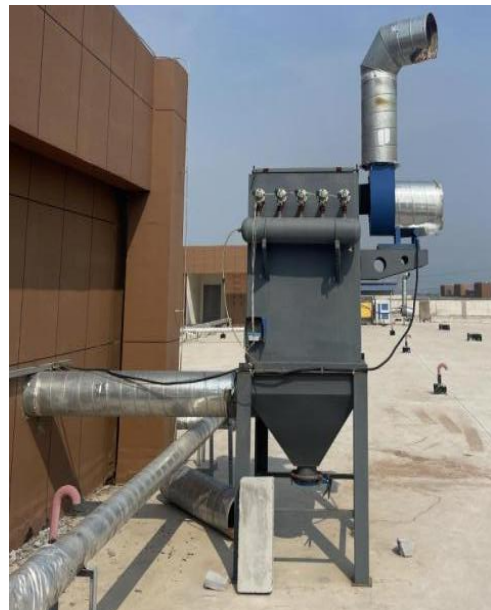
现有工程袋式除尘器
