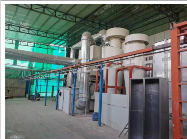
现有项目喷塑工序废气收集处理装置
