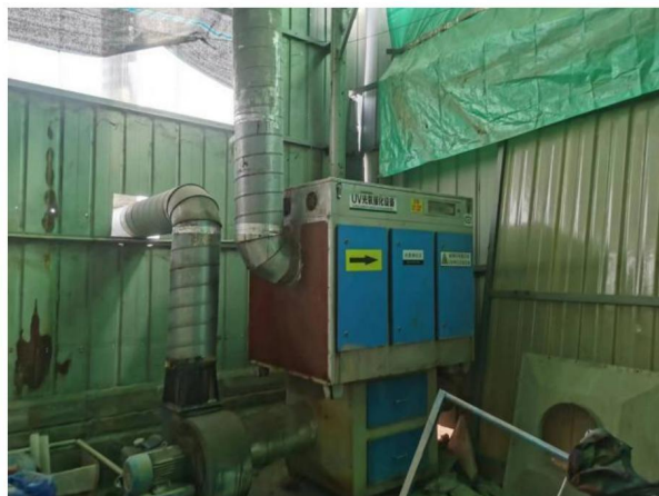
现有项目 UV+活性炭装置
