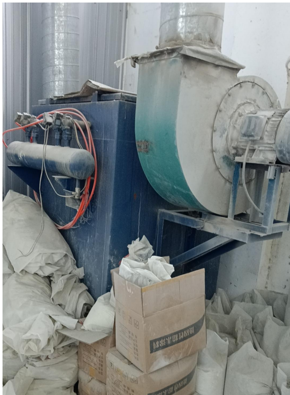
现有除尘器设备
