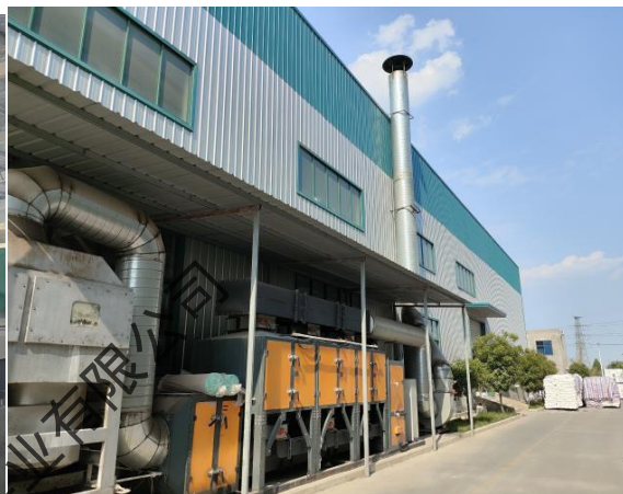
现有项目废气处理措施
