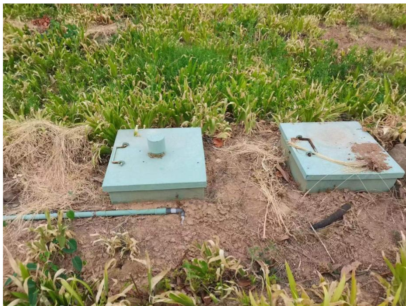
现有一体化污水处理设施
