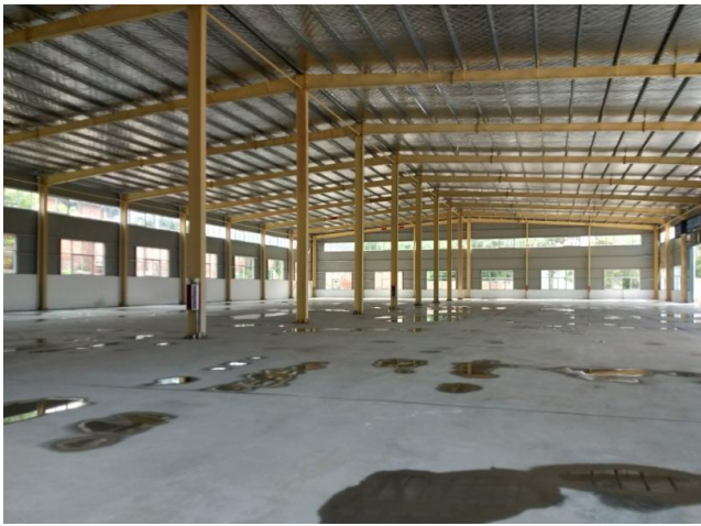
生产车间内部
