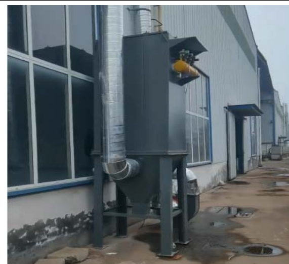
现有工程袋式除尘器
