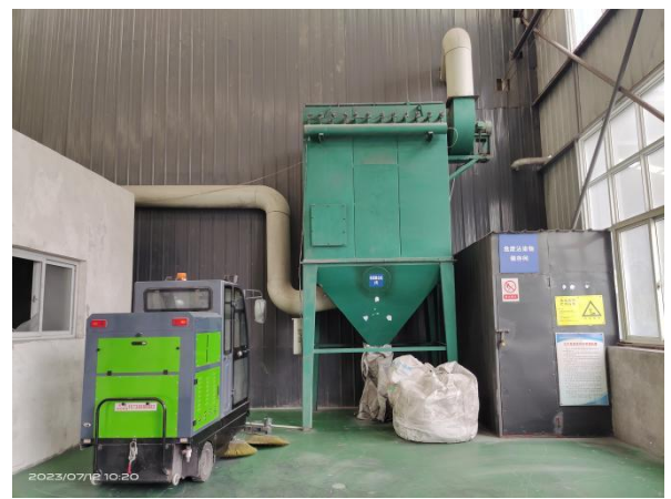
除尘器及危废暂存间
