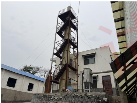
梭式窑配套的除尘器和排气筒
